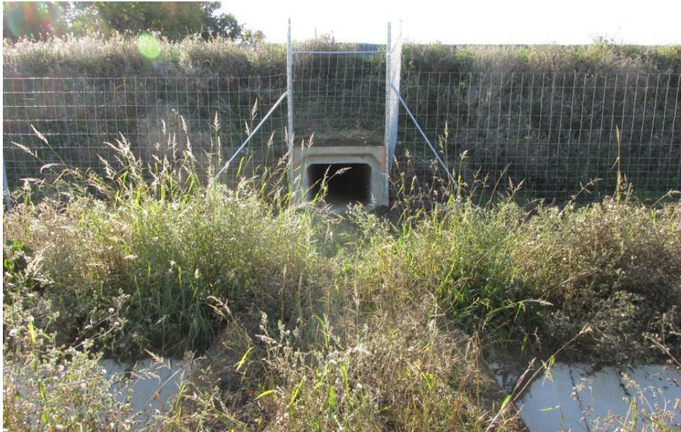
Ouvrage de passage de la petite faune sur la LGV Tours-Bordeaux (source : http://www.lgv-sea-tours-bordeaux.fr/ )
